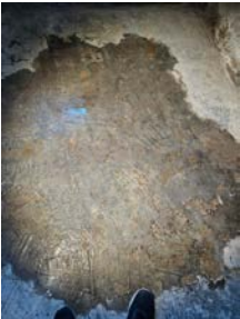
Fuktmerker på gulv under lekkasjepunkt i kjeller.
