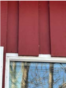
Ufagmessig avslutning av kledning over vindu.
