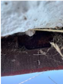
Mangelfull lufting bak kledning.
