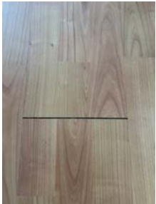
Laminatgulv i 1. etasje med sprekker i sammenføyninger.
