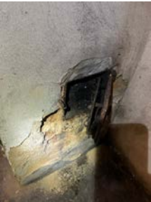
Pussavskalling på teglsteinspipe i kjeller.
