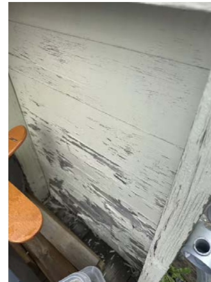
Maling flasser på rekkverk på terrasse
