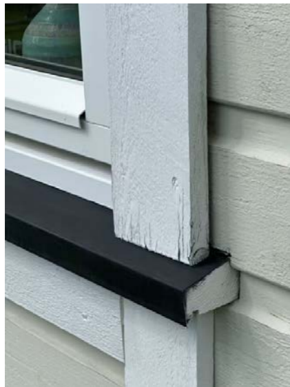
Omramming er ført direkte ned til vannbrett og har tegn til skade/råte.
