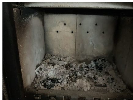
Sprekker i ildfast stein.
