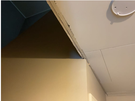
Det mangler list i overgang.
