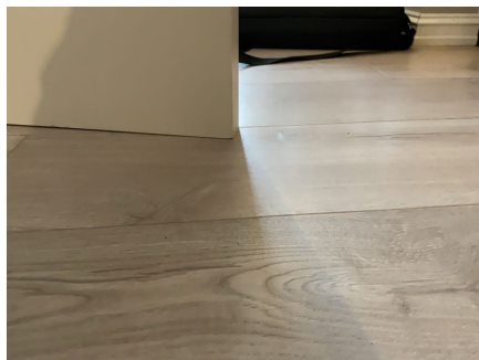
Dørblad tar i gulvet i første etasje.
