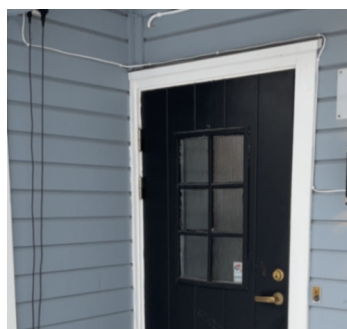
Utvendige ledninger er ikke tilstrekkelig festet.
