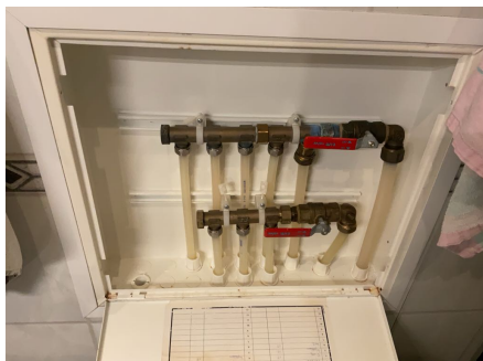
Fordelerskap er plassert på bad.
