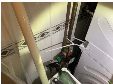
Stoppekran plasser på bad.
