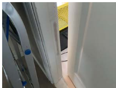
Slitasje på maling i karm
