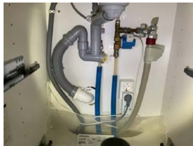
Rør-i-rør under kjøkkenbenken er ikke endetettet. Ved eventuelt lekkasje vil det være fare for at vann renner ut der.
