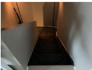
Det mangler håndløpere i trapp
