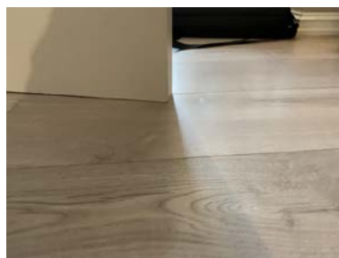
Dørblad tar i gulvet i første etasje.
