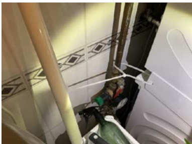
Stoppekran plasser på bad.
