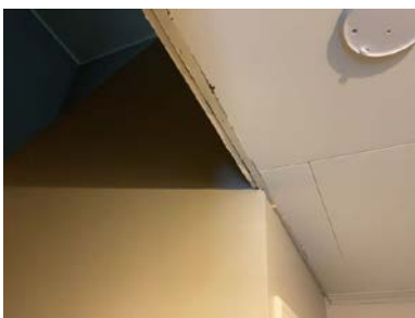
Det mangler list i overgang.
