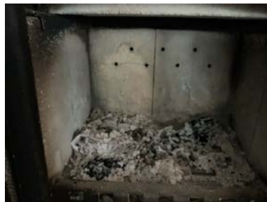
Sprekker i ildfast stein.
