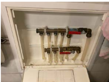
Fordelerskap er plassert på bad.
