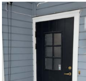
Utvendige ledninger er ikke tilstrekkelig festet.
