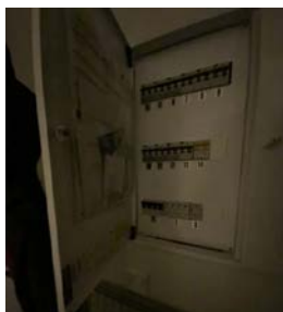
El-skap med automatsikringer.
