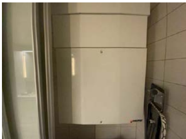
Ventilasjonsaggregat er montert inne på bad.
