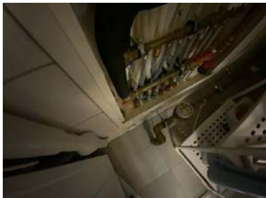
Stoppekran montert inne på Vaskerom/bad
