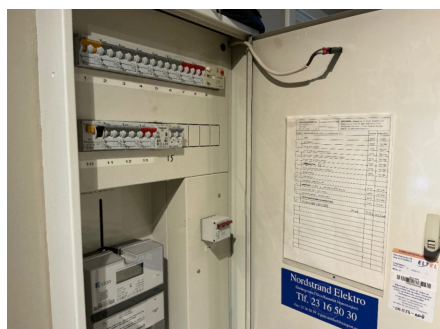
Automatsikringer i sikringsskap plassert i gang.
