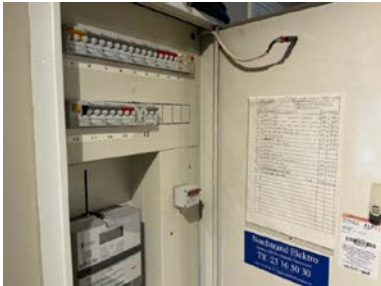
Automatsikringer i sikringsskap plassert i gang.
