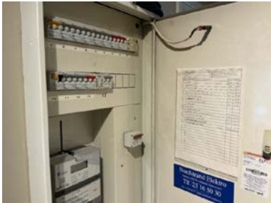
Automatsikringer i sikringskap plassert i gang.
