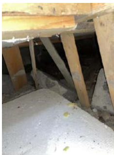
Løs isopor og stedvis ufaglig oppstøtting i bjelker.
