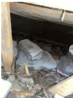
Råteskader i trevirke som ligger på bakken
