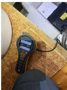
Det måles fuktverdier i treverk med ytterligere skadepotensiale.
