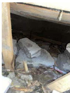
Råteskader i trevirke som ligger på bakken
