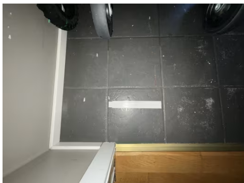
Det ble registrert «bom» i gulvflis i gang
