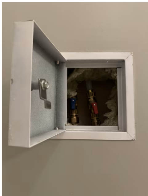
Viser stegekraner for fordelerskap ved bad i 2.etasje
