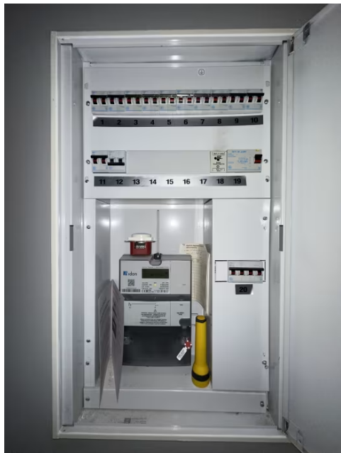
Viser sikringskapp plassert i gang 1.etasje
