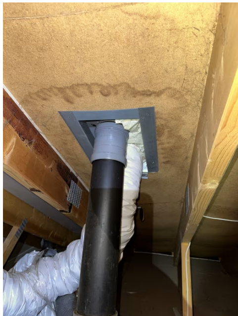
Det er påvist fuktskjolder i undertak/takkonstruksjon.
