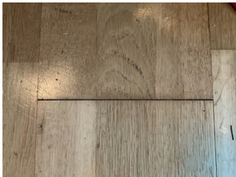
Viser eksempel på sprekker i skjøter ved gulv.
