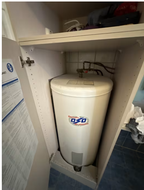
Viser bereder plassert på bad i 1.etasje
