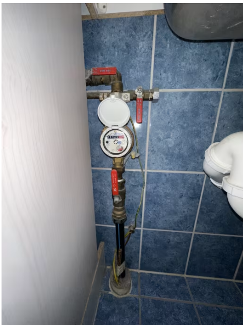
Viser vanninntak, hovedstoppekran og vannmåler plassert på bad i 1.etasje.
