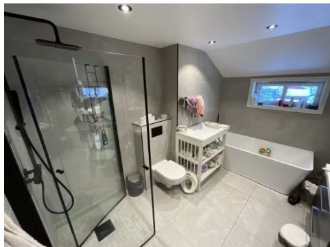
Viser innfellbare dusjdører, veggmontert termostatbatteri, dusjgarnityr, badekar, veggmontert toalett med innebygget sisterne.
