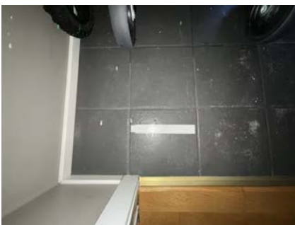
Det ble registrert «borm» i gulvflis i gang
