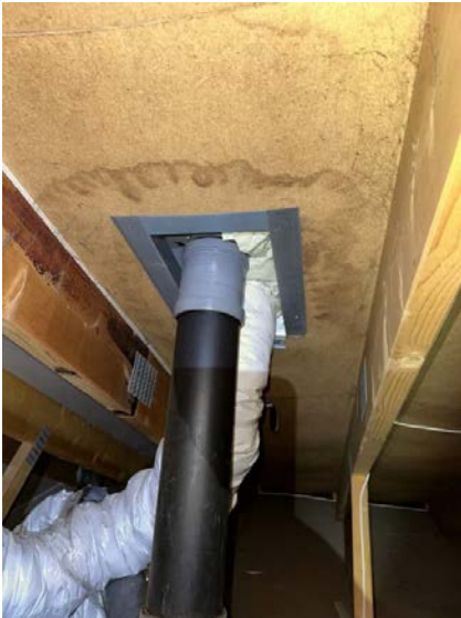
Det er påvist fuktskjolder i undertak/takkonstruksjon.
