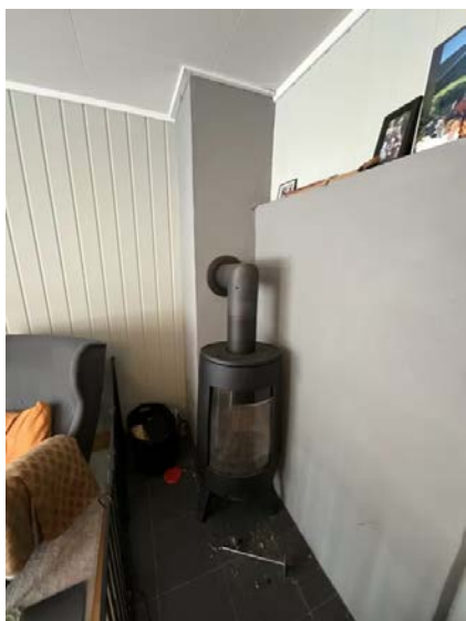
Viser ildsted plassert i stue 1. etaje
