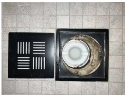
Viser sluk i dusjsonen.
