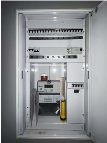
Viser sikringskapp plassert i gang 1.etasje
