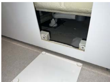
Fallforhold og sluk er ikke kontrollert under badekar pga manglende adkomst.
