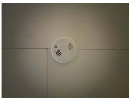
Viser brannvarsler i 1.etasje
