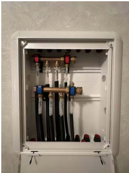
Vannrør med rør i rør system fra fordelerskap plassert i bod og frem til sanitærinstallasjoner på badrom i 2.etasje
