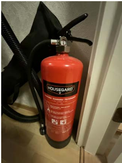
Viser brannslukningsapparat plassert i 2.etasje
