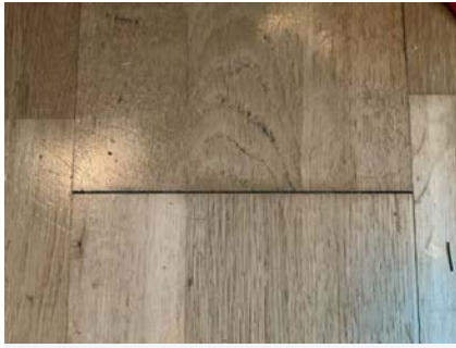
Viser eksempel på sprekker i skjøter ved gulv.
