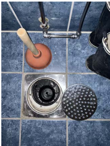
Viser sluk i dusjsonen.
