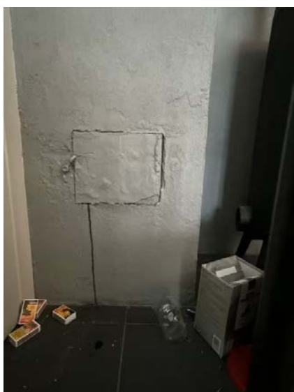
Viser sotluke, det registreres stripe etter sotvann under luke.
