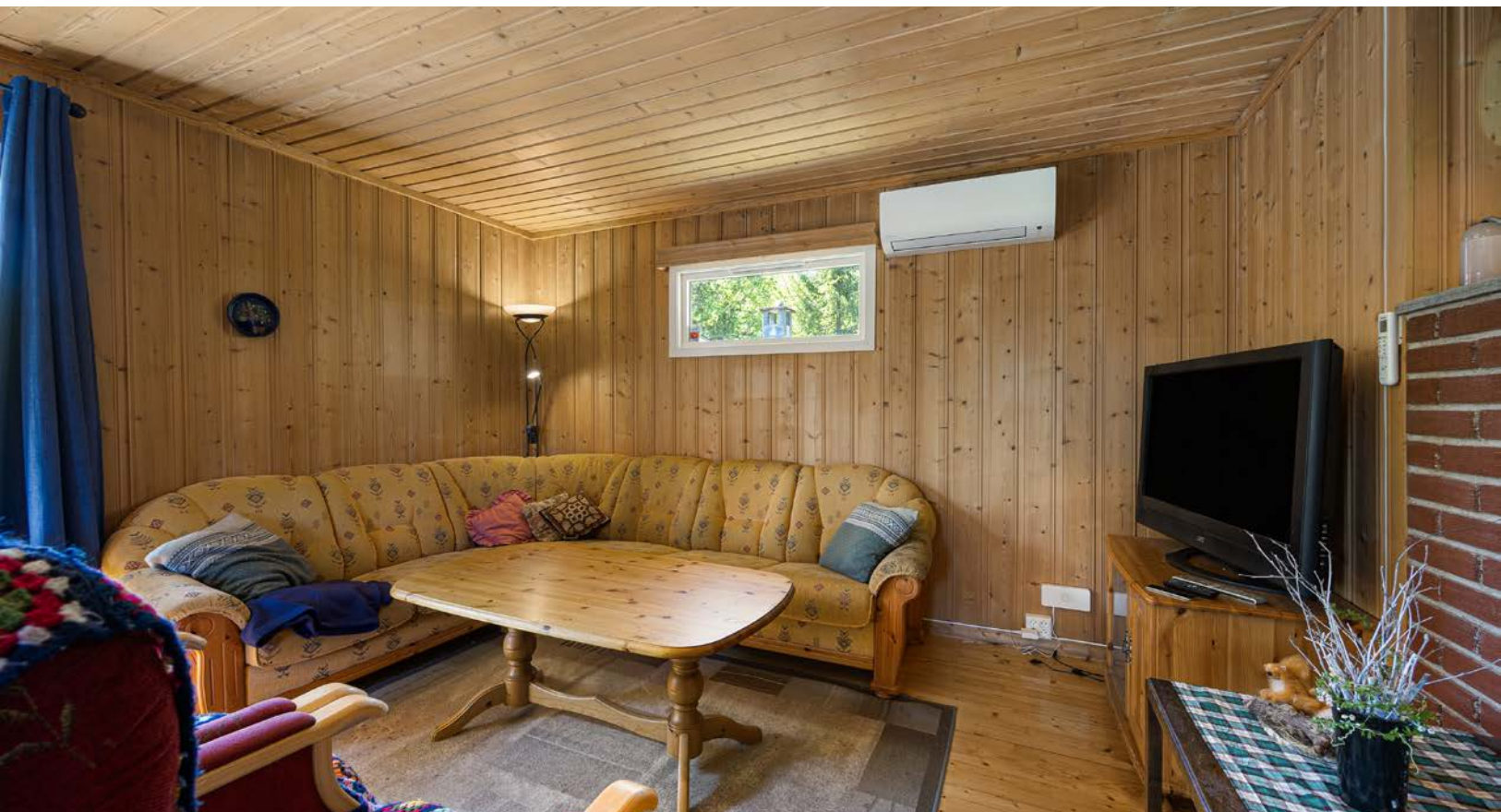
I stuen er det også oppvarming med luft til luft varmepumpe.
