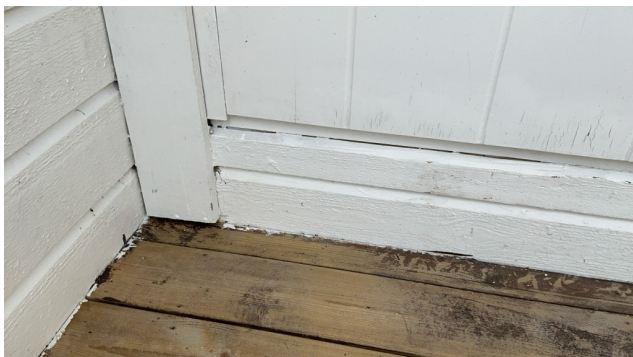
Manglende beslag under døren
