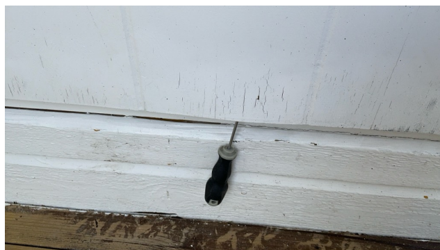
Panel slitt, og løsner fra døren
