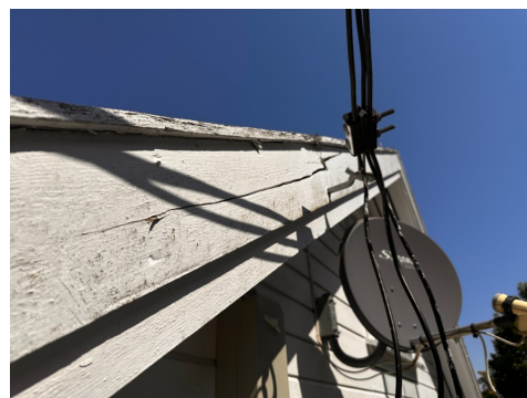
Sprekk i vindskive
