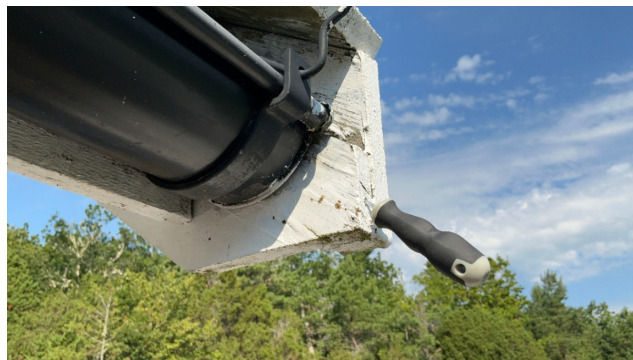
Råte i vindskive
