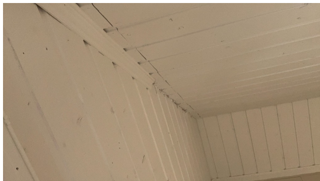
Manglende list, skjøt av panel
