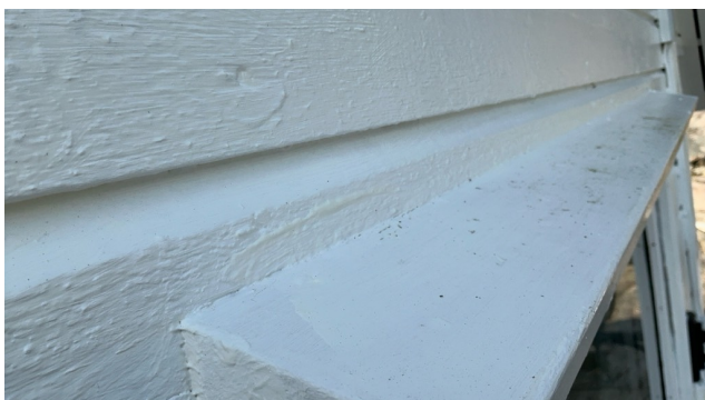
Det er påvist lite og ingen klaring mellom vannbrett og kledning.
