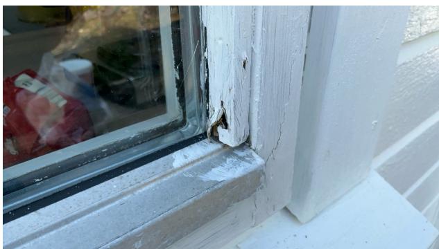
Råte i list utenpå glasset
