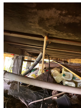
Dårlig tetting rundt rør, samt antatt tidligere lekkasje
