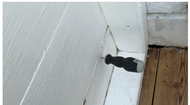
Råte i kledning
