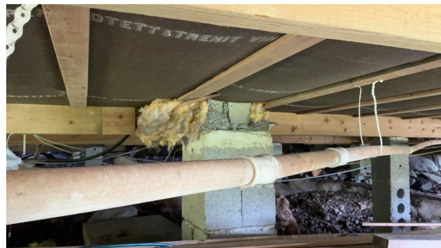
Dårlig tetting rundt pipen
