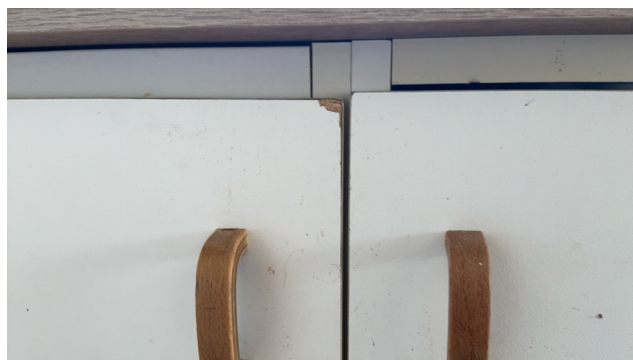
Skade på dør
