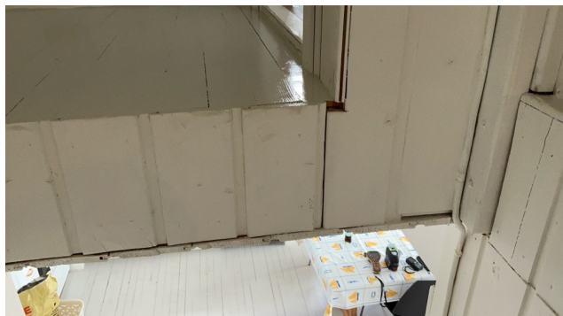
Eksempel på manglende list
