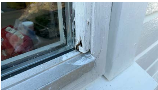
Råte i list utenpå glasset
