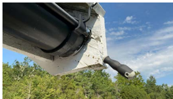
Råte i vindskive
