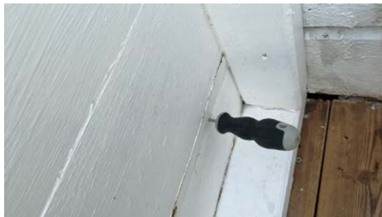
Råte i kledning
