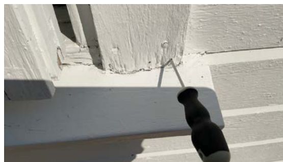
Det er påvist lite og ingen klaring mellom vannbrett og list. Råte i list
