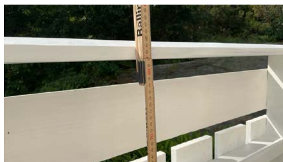
Litt lavt rekkverk på en liten del av terrassen
