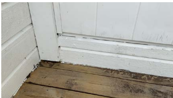
Manglende beslag under døren
