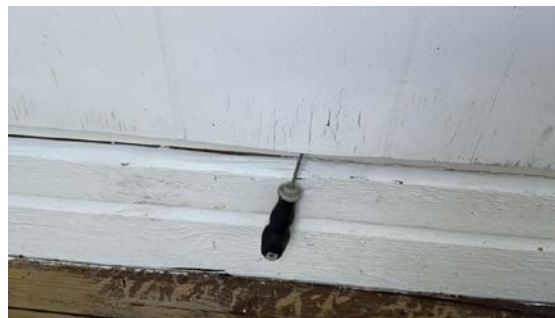
Panel slitt, og løsner fra døren
