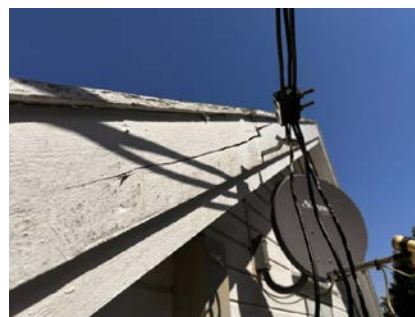
Sprekk i vindskive
