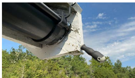
Råte i vindskive
