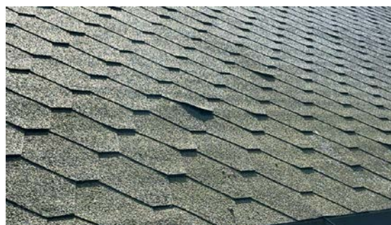
Flere steder der shingel er litt løs i underkant.
