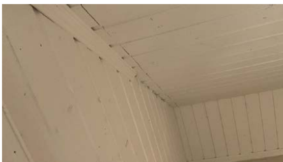
Manglende list, skjøt av panel
