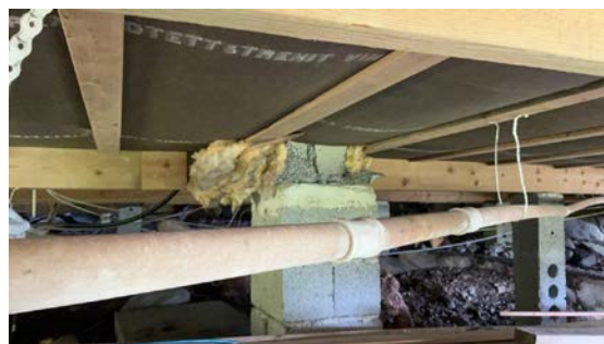
Dårlig tetting rundt pipen
