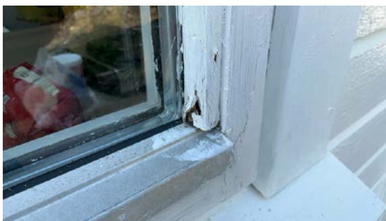
Råte i list utenpå glasset
