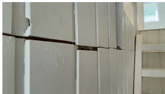
Eksempel på manglende list
