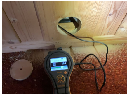
Hulltaking og fuktmåling ble foretatt, jeg målte grenseverdier for skadelig fukt og dette er en indikasjon på at veggen er utsatt for forhøyet fuktpåkjenning.
