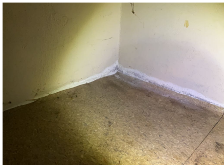
Saltutslag på vegg, dette indikerer fuktvandring i vegger.
