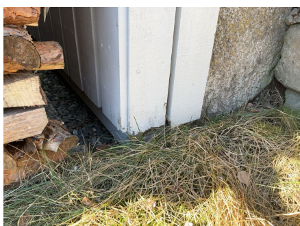
Råteskader på deler av kledning.
