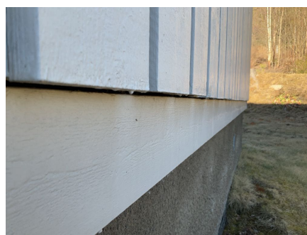
Ingen dryppkant forkorter kledningens funksjonstid. Det anbefales å etablere skrånkjære nedre del av kledningen for å begrense fuktopptrekk i treverket. Viktig at endedved overflatebehandles.
