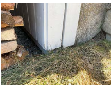
Råteskader på deler av kledning.
