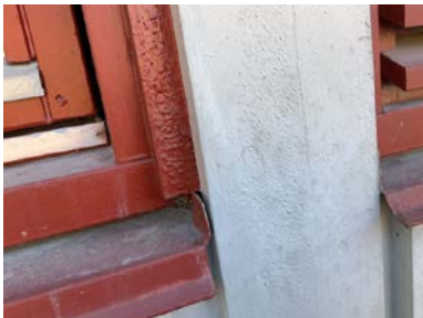
Glipper mellom vannbrett og kledning gir økt risiko for fukt-/vanninntrenging i konstruksjonene.
