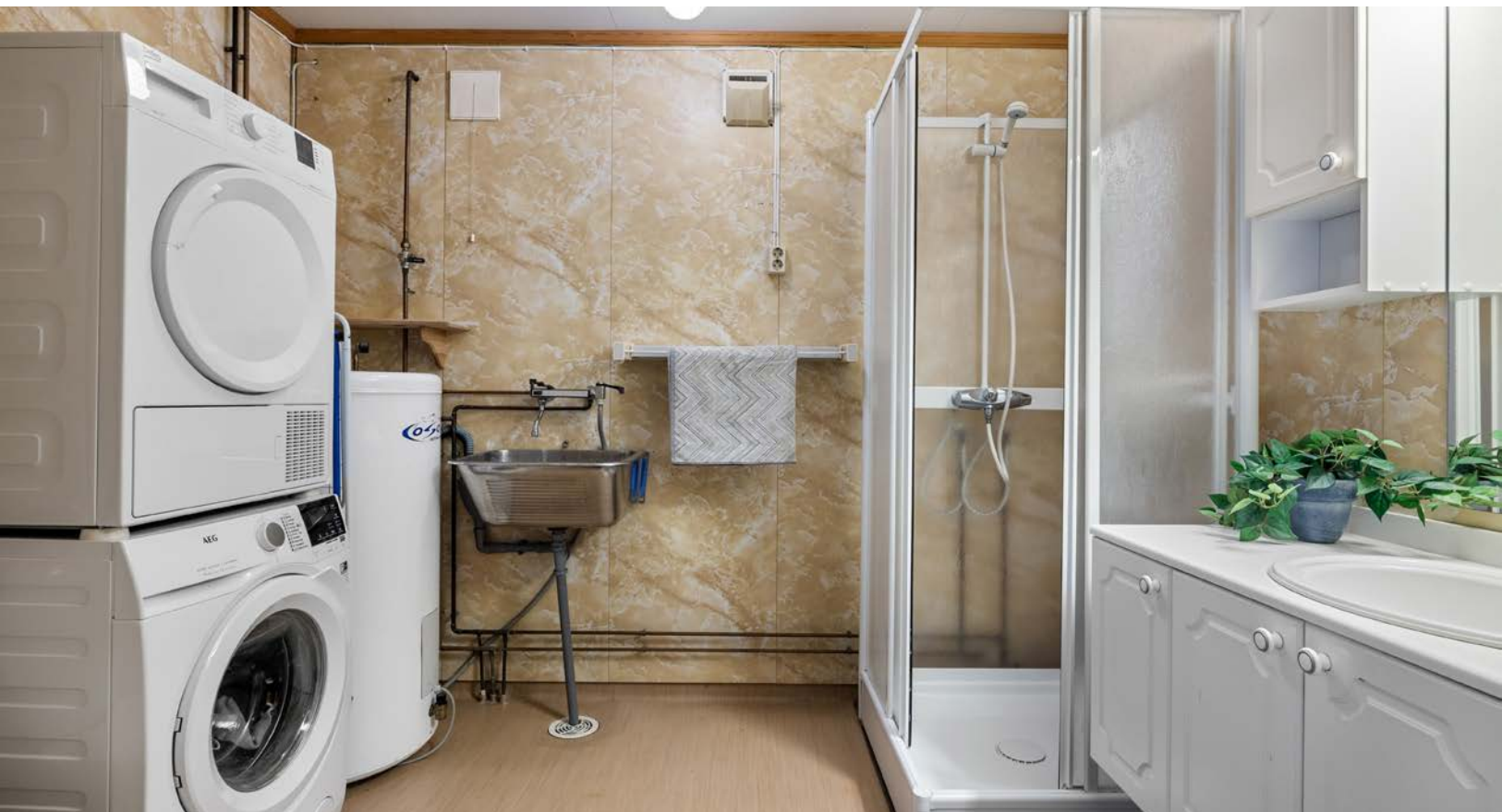
Eldre bad/vaskerom i underetasjen. Rommet har fått TG3 i tilstandsrapporten og må oppgraderes for å tåle normal bruk etter dagens krav.
