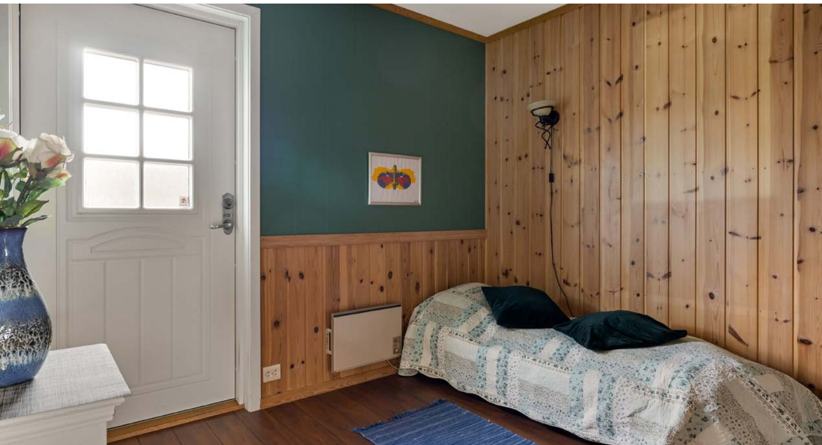
Rommet hadde opprinnelig et vindu som i dag er byttet med en inngangsdør. Rommet oppfyller dermed ikke kravet til dagslys og er ikke godkjent for varig opphold.
