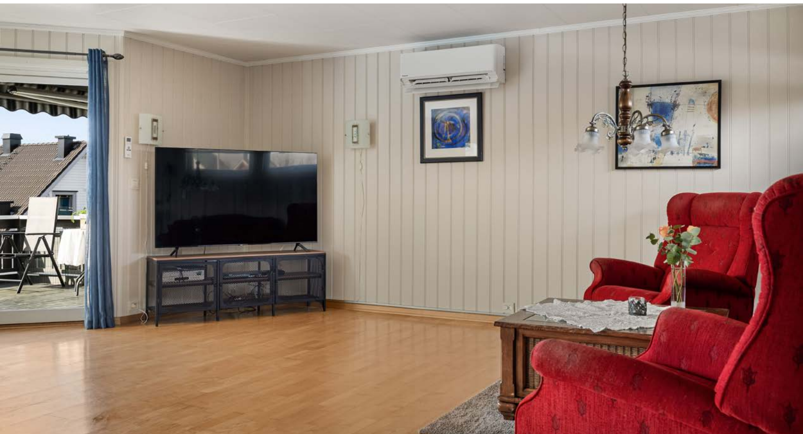
Luft-til-luft varmepumpe fra 2021 montert i stuen i 2022 (service utført i 2024).
