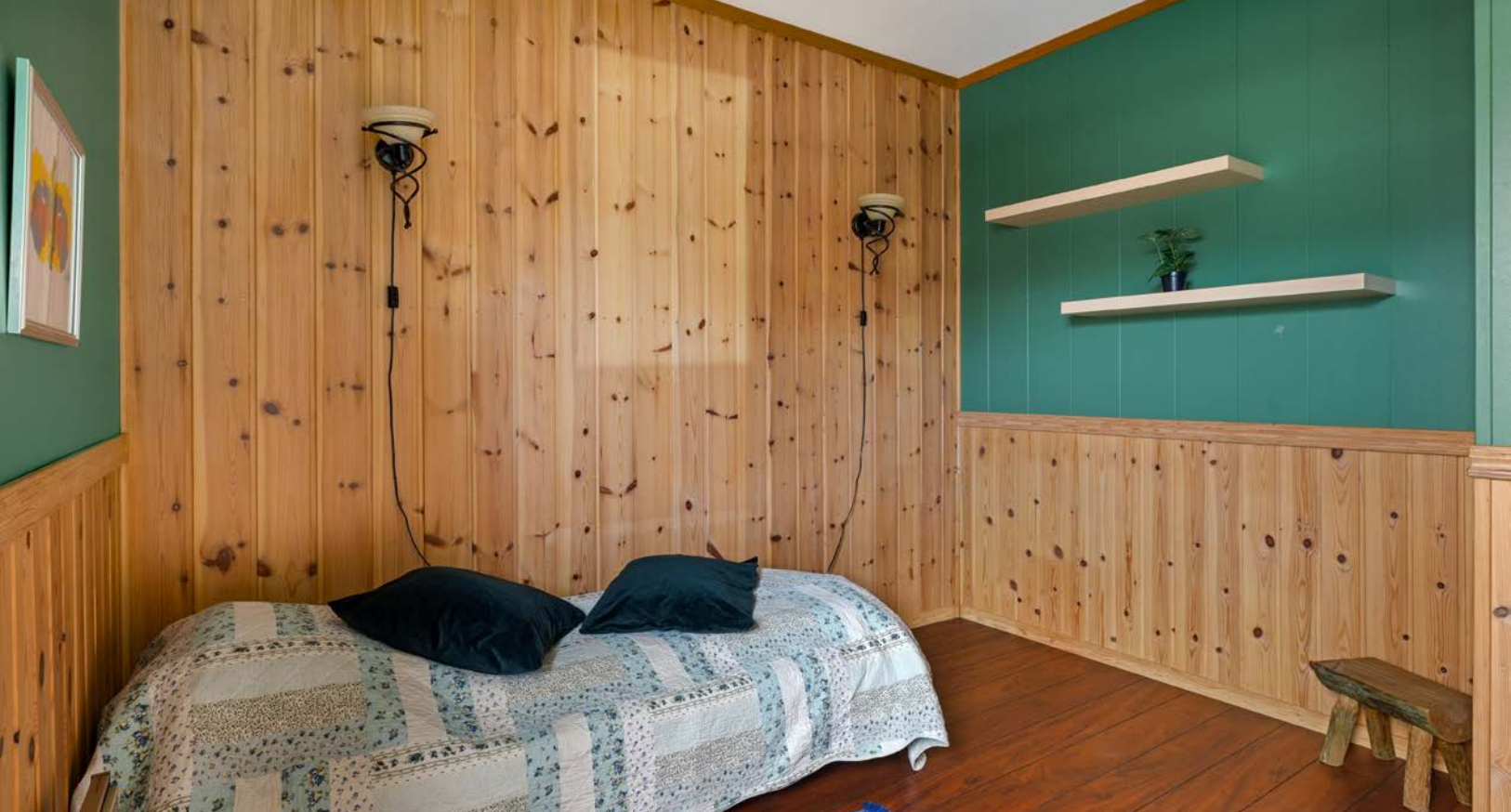
Rom i 1. etasje innredet som soverom. Rommet oppfyller ikke kravet for dagslys og er således ikke godkjent til varig opphold.
