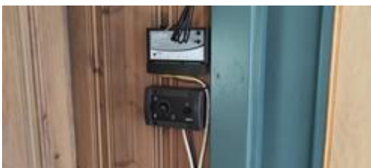
Styringspanel for varmeovn.
