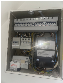
Sikringsskap med automatsikringer.
