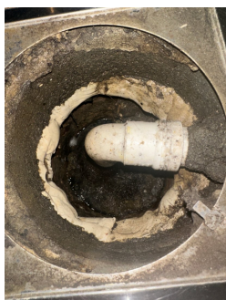
Sluk plassert utpå gulvet på bad
