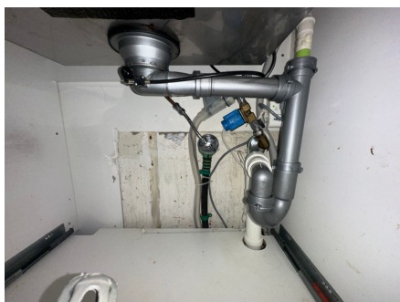
Røropplegg i kjøkkenbenk med Waterguard
