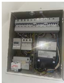
Sikringskapp med automatsikringer.
