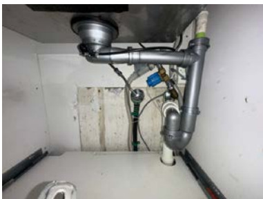
Røropplegg i kjøkkenbenk med Waterguard
