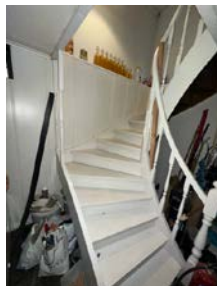
Manglende rekkverk i trapp mot kjeller
