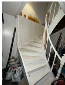
Manglende rekkverk i trapp mot kjeller
