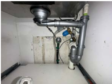
Røropplegg i kjøkkenbenk med Waterguard
