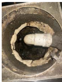
Sluk plassert utpå gulvet på bad
