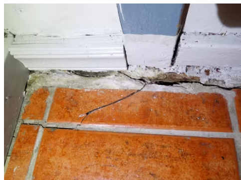
Sprekker i flis mot yttervegg ved ytterdør.
