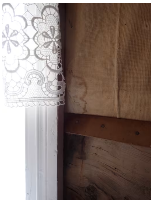
Fuktmerke ved vindu i bod.
