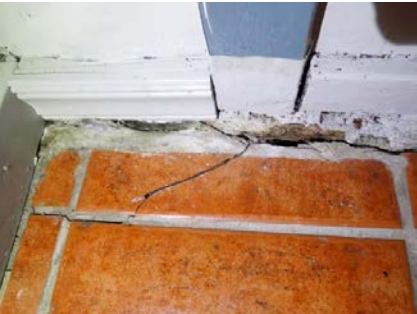
Sprekker i flis mot yttervegg ved ytterdør.
