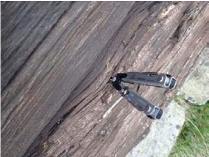
Råte i tømmer utvendig.
