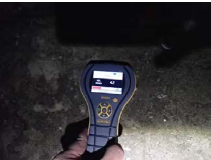
Bemerk at tallet på måleren ikke stemmer på dette bildet. Det er en del opptrekk av fukt i mur/gulv.
