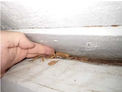
Råte i tømmer over vindu i gang i 2. etasje.
