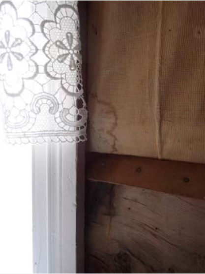
Fuktmerke ved vindu i bod.
