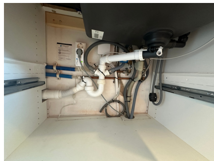
Røropplegg i kjøkkenbenk med Waterguard
