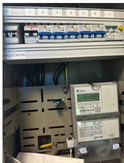
Sikringsskap med automatsikringer.
