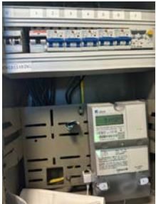
Sikringsskap med automatsikringer.
