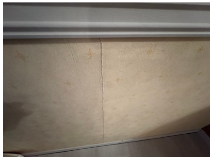
Eksempel på slitasje/skade som er utover hva man kan forvente.
