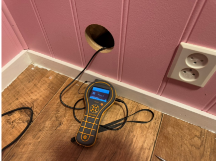
Fuktmåling mot dusjkabinettet.
