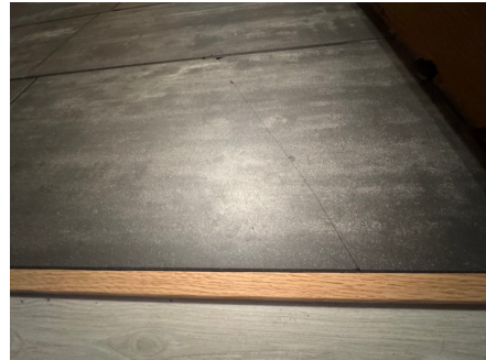
Eksempel på skadet flis på kjøkkenet.
