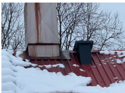
Avvik i beslagløsningen ved luftelyre.
