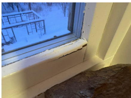
Tegn til innvendig kondensering.
