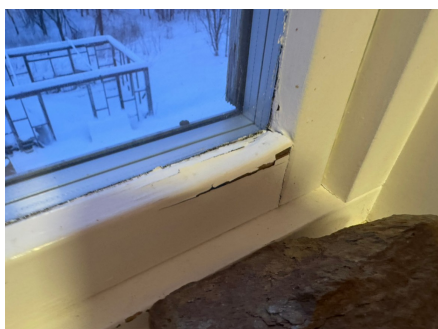
Tegn til innvendig kondensering på vindu.
