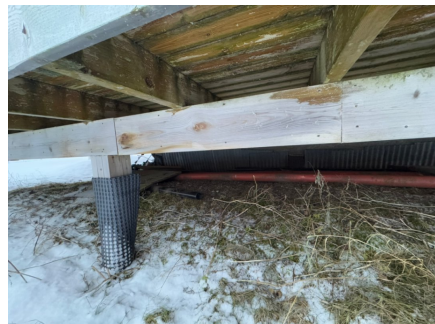
Drageren er ikke skjøtet over søyle.
