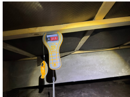
Fuktmåling i lekter i krypekjelleren.
