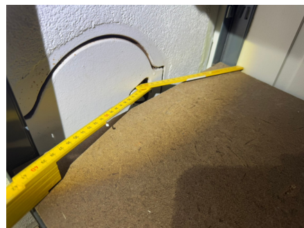
Ikke tilgjengelig sotluke, for liten avstand til brennbart materiale.
