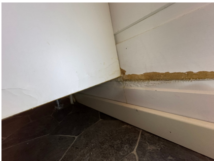
Skader på servantskap og vegg.
