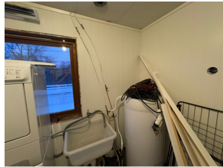
Ufagmessig utførelse av vannrørene, manglende klamring.
