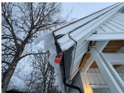
Eksempel på råteskade.
