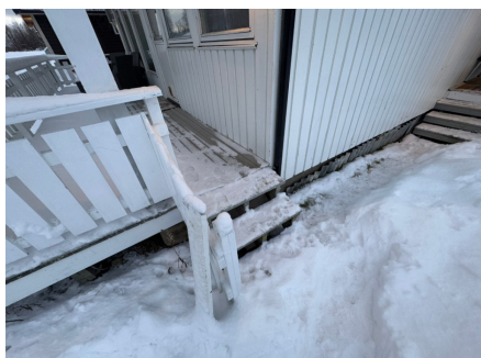
Manglende håndlist og rekkverk.
