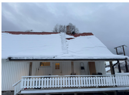
Manglende takstige på overbygget til trappen.
