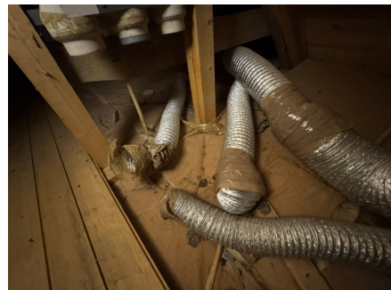
Boligens avtrekksvifte er frakoblet.
