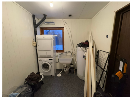
Manglende tettesjikt ved utslagsvask, vindu i våtsonen.
