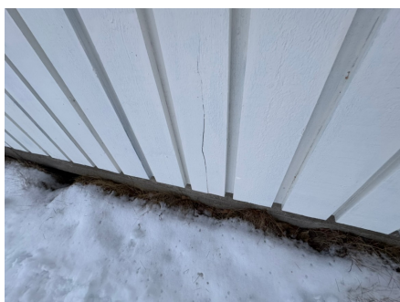
Eksempel på sprekke i kledningen.
