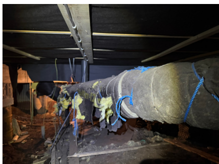
Eksempel på manglende klamring av rør.
