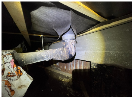
Løst avløp, tegn etter lekkasje.
