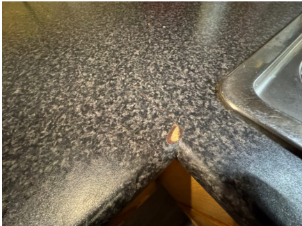
Skade på benkeplaten.
