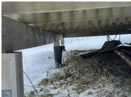
Skjevheter i konstruksjonen.
