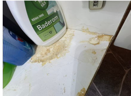
skader i servantskap.
