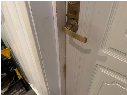
Skader/slitasje utover hva man normalt kan forvente. Kloremarker etter katt.
