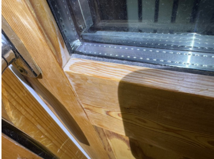
Tegn til innvendig kondensering.
