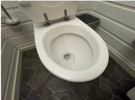
Merker i toalettskålen etter lekkasje på sisternen.
