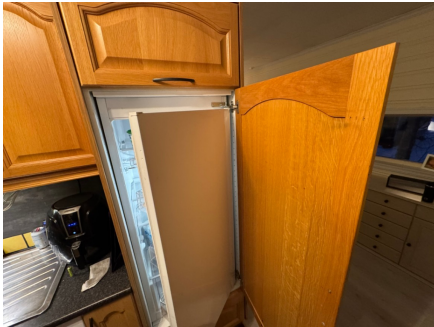
Kjøleskapet er ikke montert.
