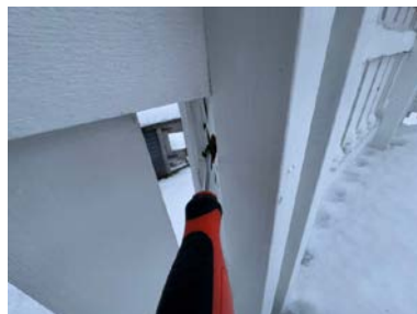
Eksempel på råteskadet rekkverk.
