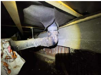
Løst avløp, tegn etter lekkasje.
