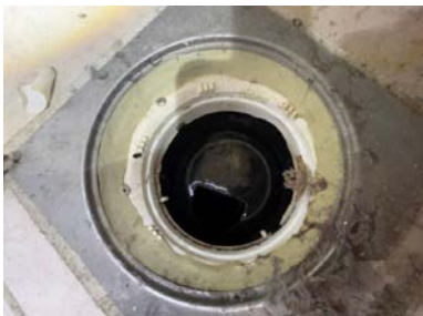
Ikke mulig å se membran ved sluken på grunn av fugemasse.
