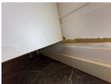
Skader på servantskap og vegg.
