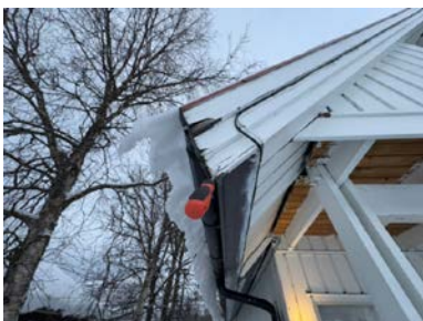
Eksempel på råteskade.
