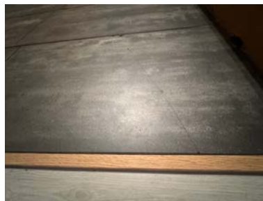
Eksempel på skadet flis på kjøkkenet.
