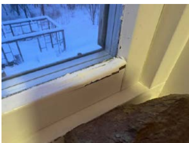
Tegn til innvendig kondensering på vindu.
