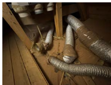
Boligens avtrekksvifte er frakoblet.
