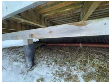
Drageren er ikke skjøtet over søyle.
