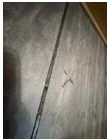
Eksempel på slitasje/skade som er utover hva man kan forvente.
