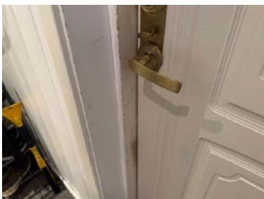
Skader/slitasje utover hva man normalt kan forvente. Kloremærker etter katt.
