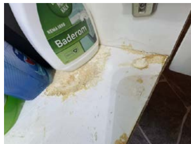
skader i servantskap.
