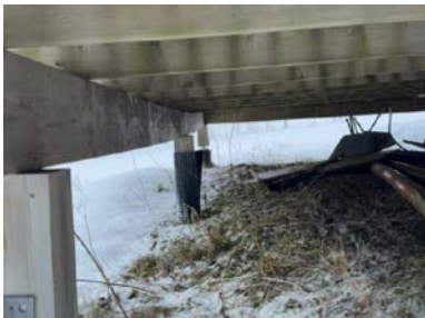
Skjevheter i konstruksjonen.
