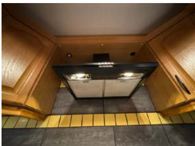
Manglende deksel framfor lysene.
