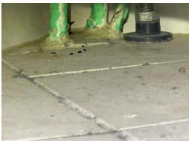
Ikke benyttet mansjetter ved rørgjennomføringer, løs membran fra røret.
