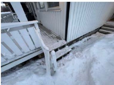
Manglende håndlist og rekkverk.
