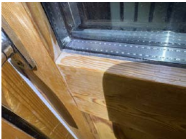
Tegn til innvendig kondensering.
