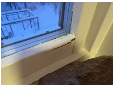
Tegn til innvendig kondensering.
