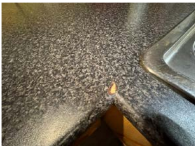
Skade på benkeplaten.
