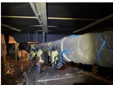
Eksempel på manglende klamring av rør.
