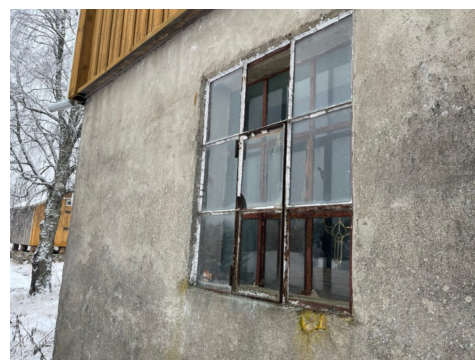
Vindu med manglende og sprekke glass.
