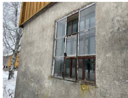
Vindu med manglende og sprekke glass.
