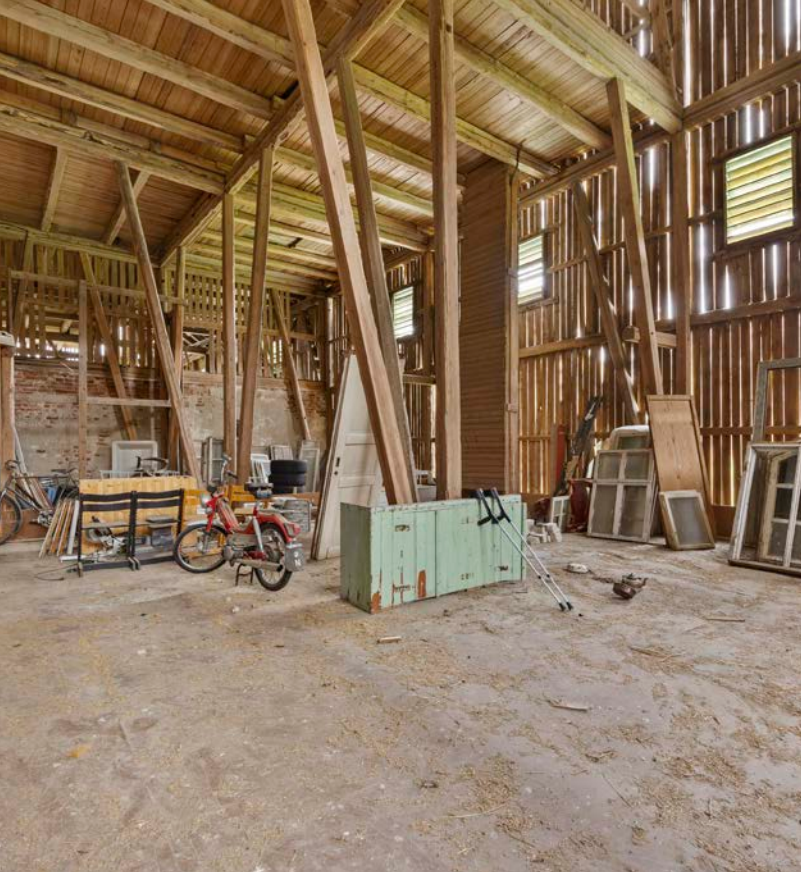
Hele bygget har innlagt strøm, og det er innlagt vann i fjøsdelen.
