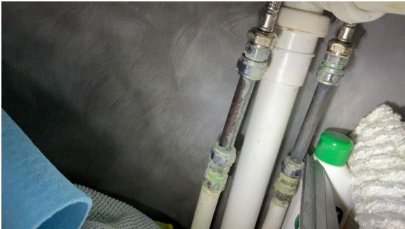
Irr/korrodering på kobling.
