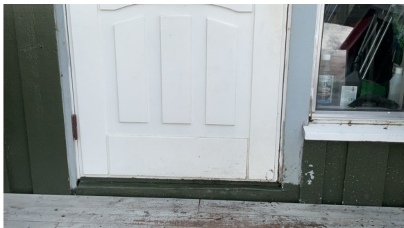
Slitasje på ytterdør.
