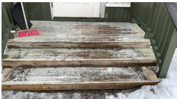
Slitasje på trapp.
