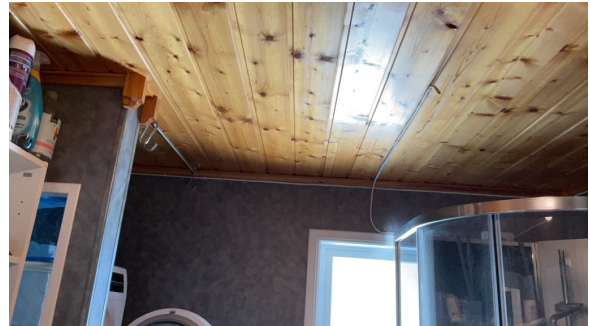
Nedsenk på himling på bad 1. etasje.
