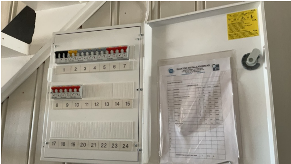
1 av 3 sikringskapp plassert i gang 1. etasje.
