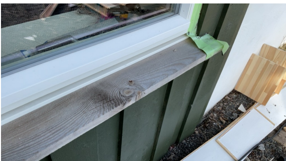
Manglende beslag på vannbrett.
