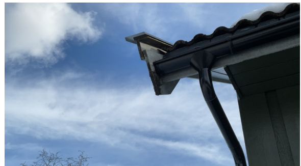
Slitasje på vindskier.
