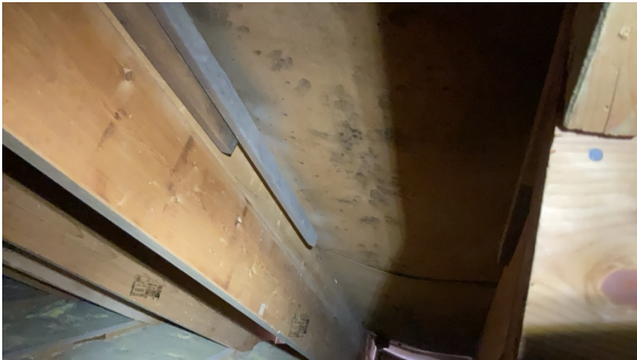
Misfarging på undertaksplater.
