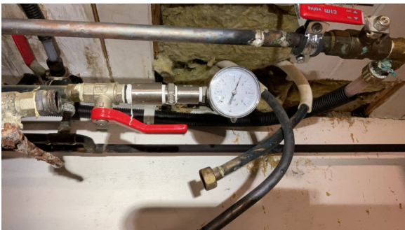
Lekkasje fra manometer.
