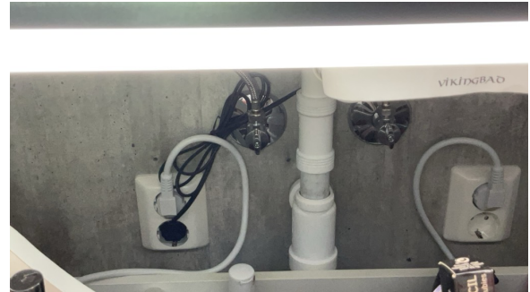
Installasjon med lav ip grad plassert i sone 1 på våtrom.
