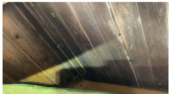
Kraftig misfarging på undertak på møneloft.
