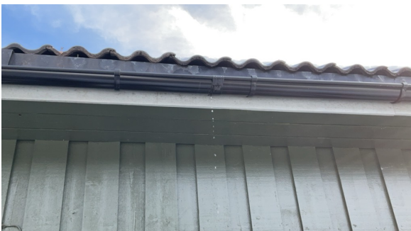
Takrenner har punktvis lekkasjer.
