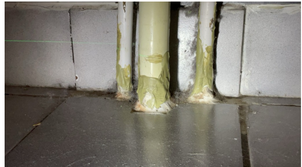
Utettheter i membran rundt rørgjennomføringer.
