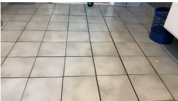
Ufagmessig utførelse på flislegging.
