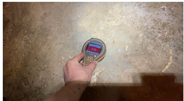
Ved enkle fuktsøk på gulv ble det registrert områder med forhøyde verdier.
