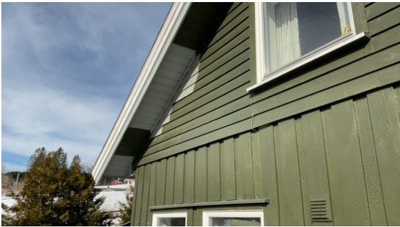
Ufullstendig maling av kledning.
