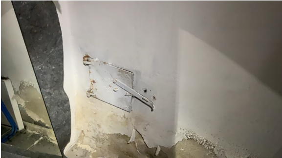
Skader på sotluke i kjeller.
