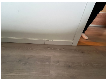
Gulvlist på soverom, kuttet for kabel.
