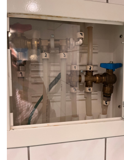
Merkede rørkurser og stoppekraner.
