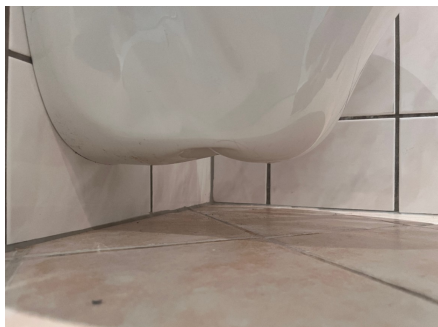
Ikke drensåpning for den innebygde vannsisternen
