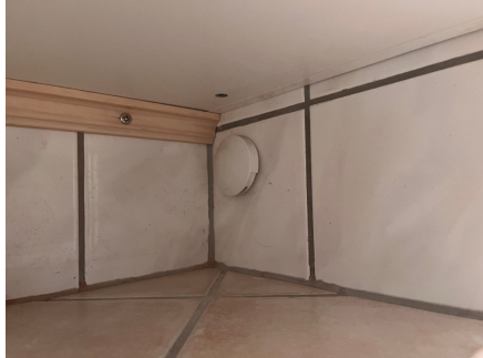
Drenering fra fordelerskap
