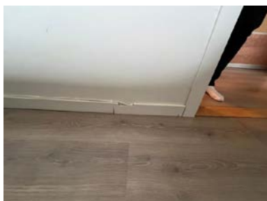
Gulvlist på soverom, kuttet for kabel.
