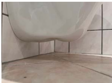
Ikke drensåpning for den innebygde vannsisternen
