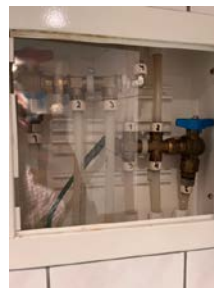
Merkede rørkurser og stoppekraner.
