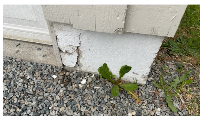
Synlig skade på grunnmur på garasje
