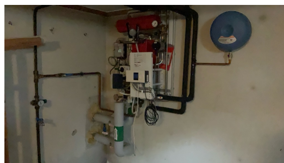
Nyere sentral med fjernvarme.
