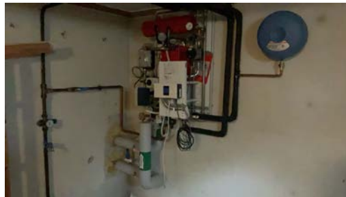
Nyere sentral med fjernvarme.
