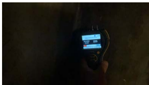
Forhøyede fuktverdier registrert ved nedre del av vegg i bod.
