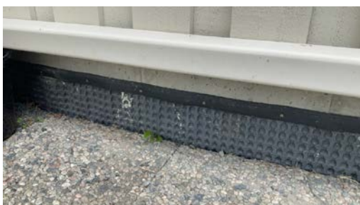
Synlig grunnmursplast på mur til påbygg fra 2009
