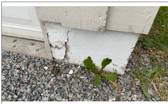
Synlig skade på grunnmur på garasje
