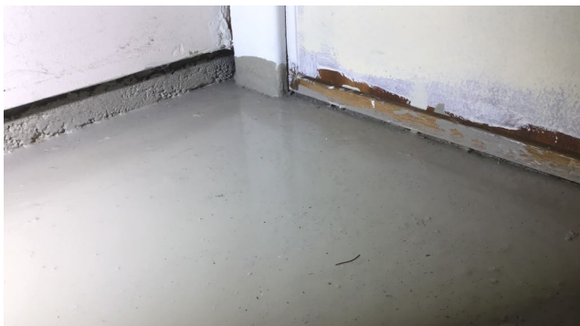
Utett i overgang gulv/ta
