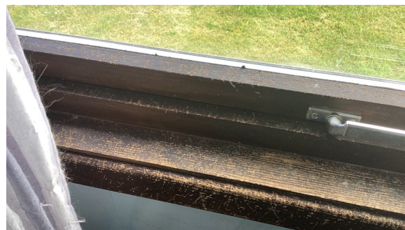
Kraftig innvendig slitasje på enkelte vinduer.
