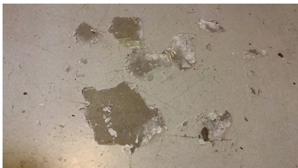
Avskaling på gulv.
