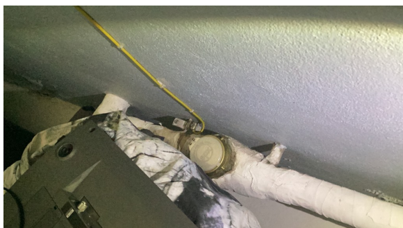
Stoppekran i kjeller.
