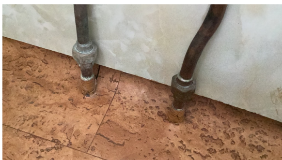
Utette gjennomføringer i gulv.
