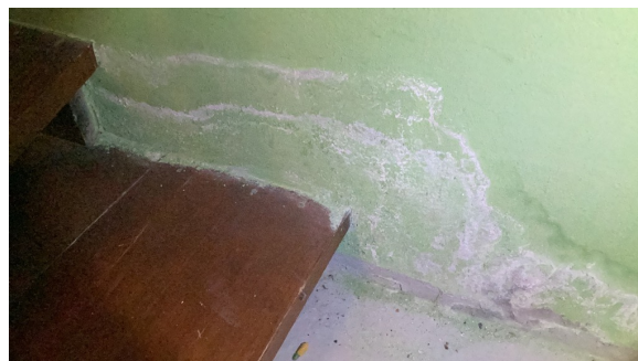
Eksempel på saltutslag på vegg.
