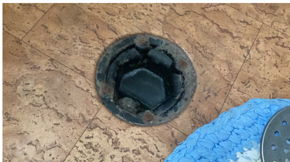
Sluk av plast med klemring.
