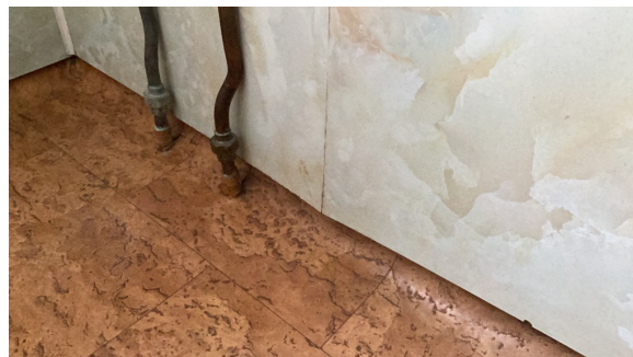
Fuktskader på veggplater.
