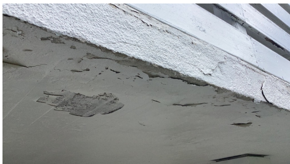
Avskaling på undersiden av betongdekke.
