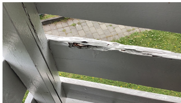
Råte i kledning på rekkverk.
