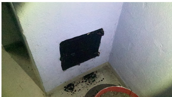
Sotluke i kjeller.
