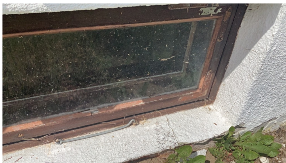
Slitasje og avskaling av kitt på kjellervinduer.
