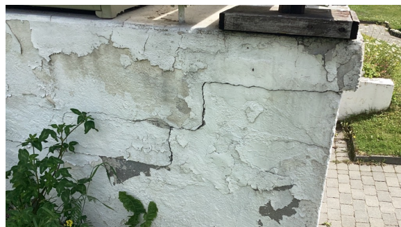
Eksempel på sprekker.
