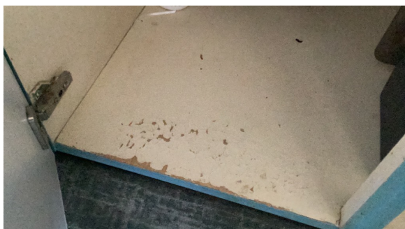
Eksempel på slitasje.
