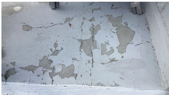
Slitasje på gulv.
