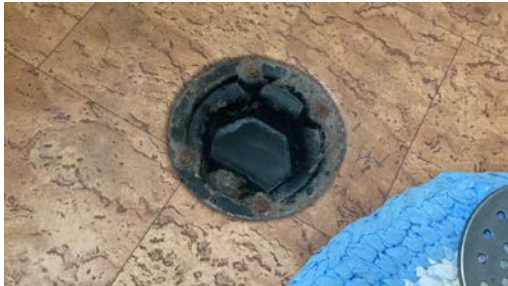
Sluk av plast med klemring.
