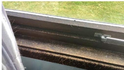
Kraftig innvendig slitasje på enkelte vinduer.
