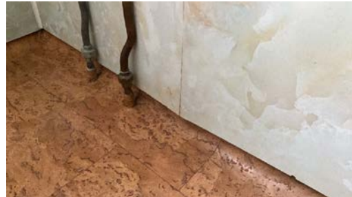
Fuktskader på veggplater.
