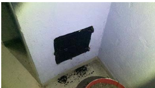
Sotluke i kjeller.
