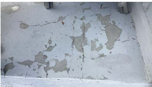
Slitasje på gulv.
