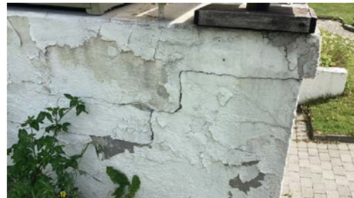
Eksempel på sprekker.
