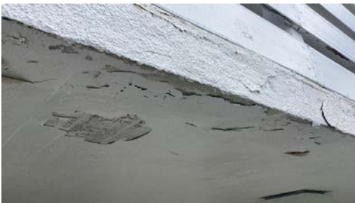
Avskaling på undersiden av betongdekke.
