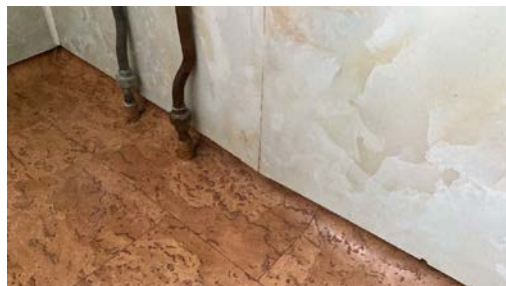
Fuktskader på veggplater.
