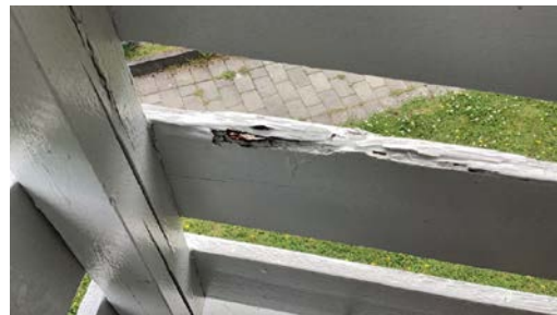
Råte i kledning på rekkverk.
