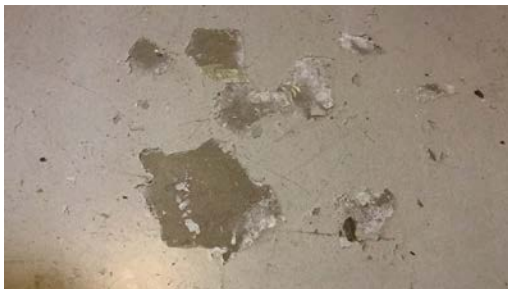
Avskaling på gulv.
