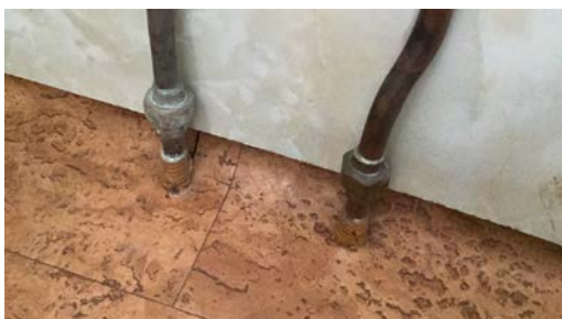
Utette gjennomføringer i gulv.
