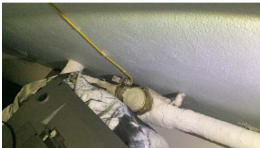
Stoppekran i kjeller.
