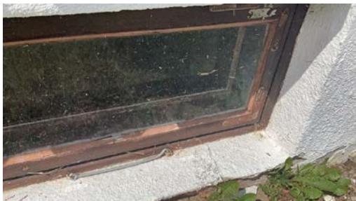
Slitasje og avskaling av kitt på kjellervinduer.
