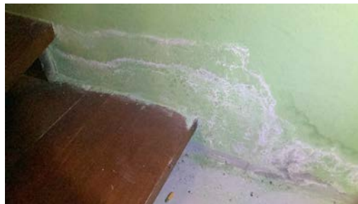
Eksempel på saltutslag på vegg.
