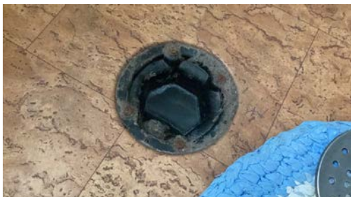
Sluk av plast med klemring.
