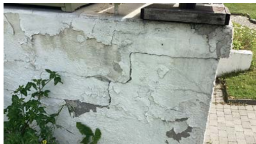
Eksempel på sprekker.
