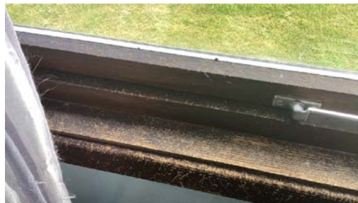
Kraftig innvendig slitasje på enkelte vinduer.
