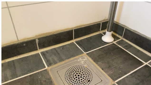
Ufagmessig fuging på vegger.
