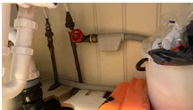
Kobberrør i kjøkkenbenk.
