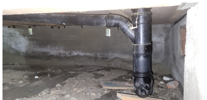
Salt på innvendige betongvegger.
