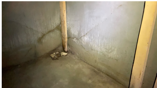
Kondensvann på innvendig murvegg under trapp.
