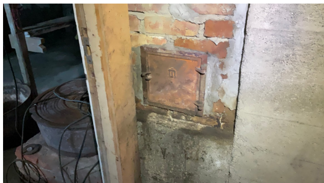
Sotluke i kjeller.
