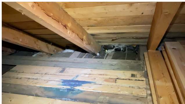
Ingen lufting ut over raft
