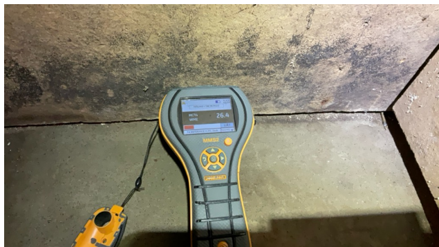
Fuktmåling i vegg viste forhøye fuktverdier i treverk.
