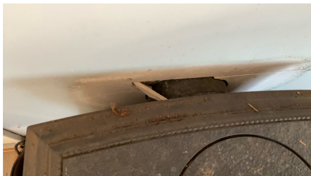
Sprekke i overflater ved røykrør.
