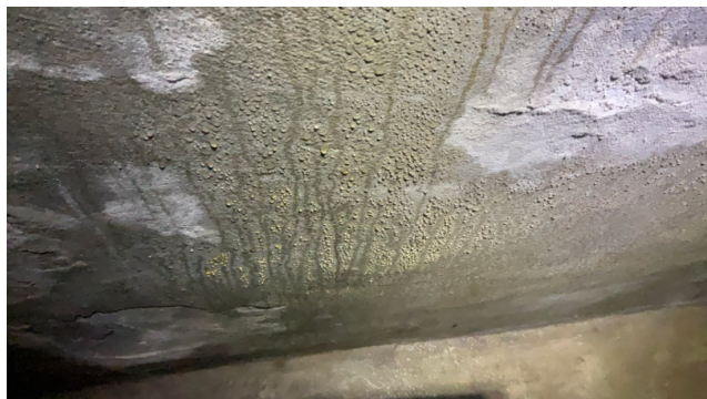
Synlig kondensvann på mur i kjeller.
