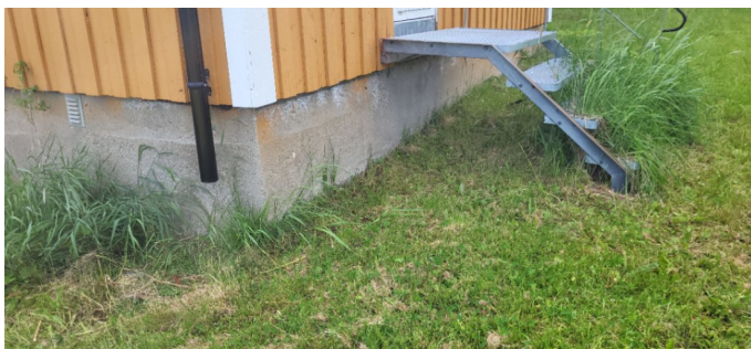
Manglende overvannsrør under bakkenivå.
