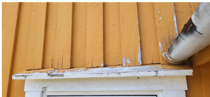
Manglende beslag på vannbrett.
