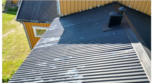
Taktekke tilbygg. Slitasje på overflatebehandling.
