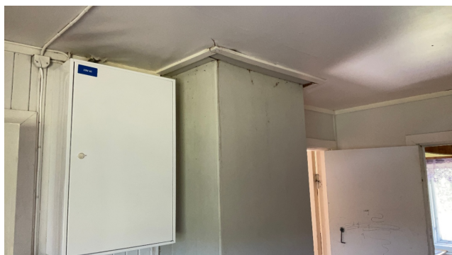
Skade i himling rundt pipe.
