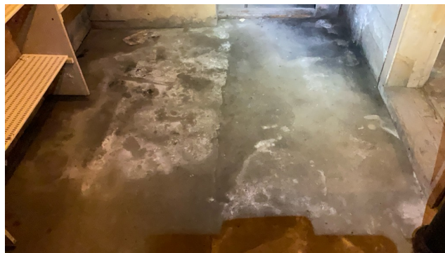
Saltutslag på gulv.
