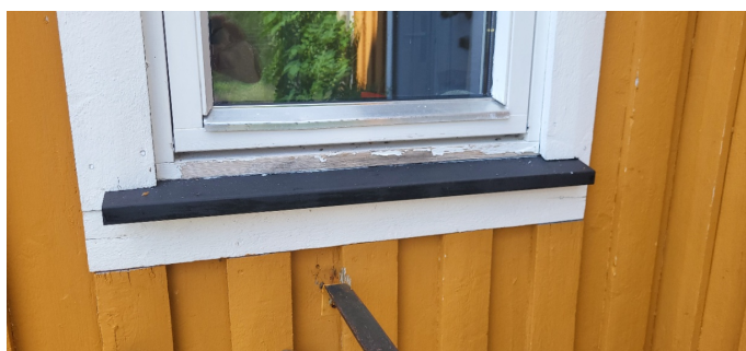
Malingsavflassing på karm.
