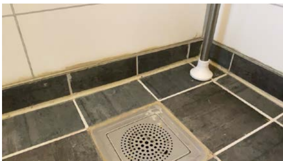
Ufagmessig fugging på vegger.
