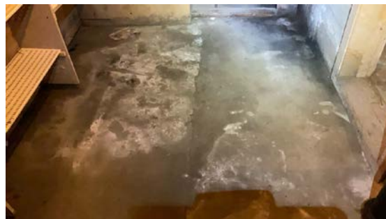
Saltutslag på gulv.
