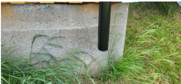
Vertikalt/skråriss riss kan være svinn (uttørking) i betongen.
