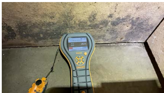
Fuktmåling i vegg viste forhøyede fuktverdier i treverk.
