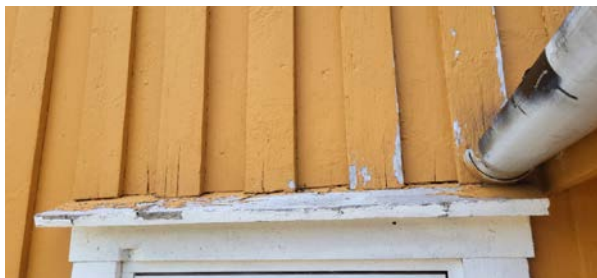
Manglende beslag på vannbrett.
