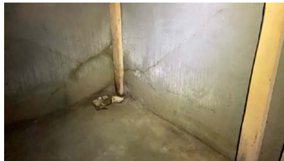
Kondensvann på innvendig murvegg under trapp.
