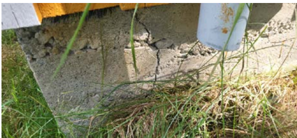
Sprekker i grunnmur uten puss.
