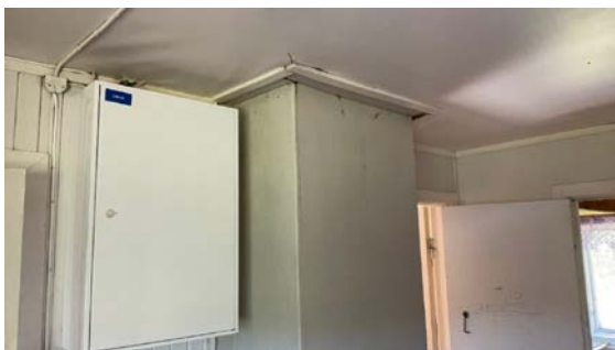
Skade i himling rundt pipe.
