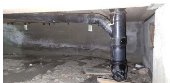
Salt på innvendige betongvegger.
