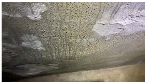
Synlig kondensvann på mur i kjeller.
