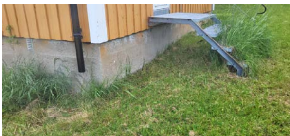
Manglende overvannsrør under bakkenivå.
