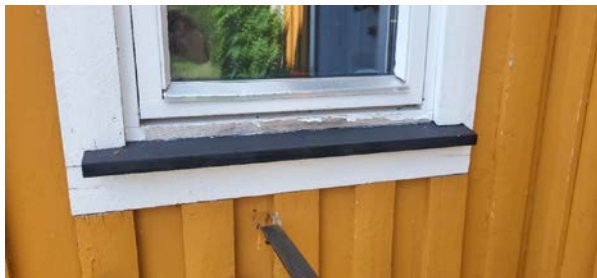
Malingsavflassing på karm.
