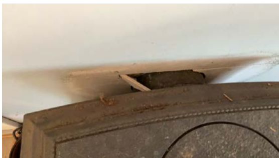
Sprekk i overflater ved røykrør.
