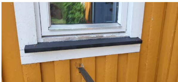
Malingsavflassing på karm.
