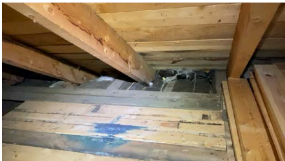
Ingen lufting ut over raft
