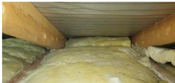
Ingen lufting ut over raft og spor av mus.
