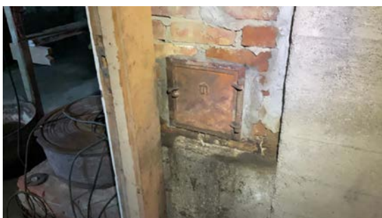
Sotluke i kjeller.
