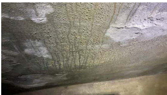
Synlig kondensvann på mur i kjeller.
