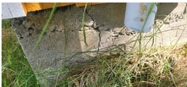
Sprekker i grunnmur uten puss.
