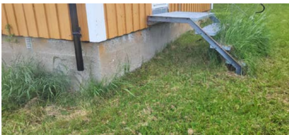
Manglende overvannsrør under bakkenivå.
