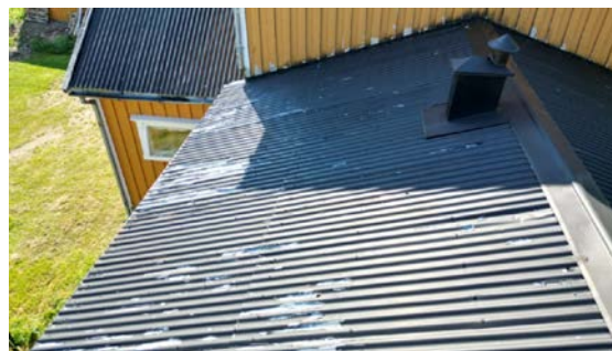
Taktekke tilbygg. Slitasje på overflatebehandling.
