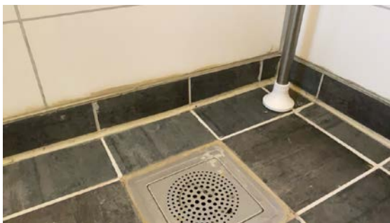
Ufagmessig fugging på vegger.
