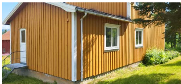
Mot vest er det helling inn mot grunnmur
