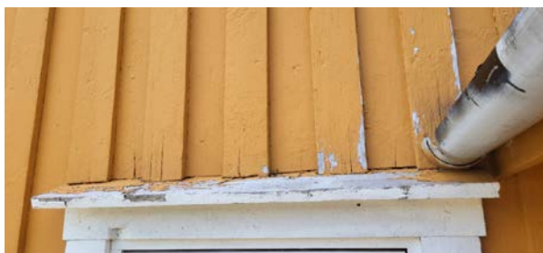
Manglende beslag på vannbrett.
