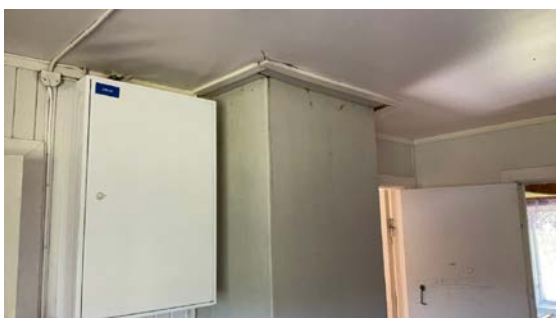
Skade i himling rundt pipe.
