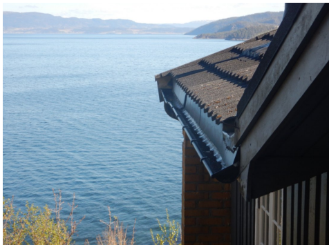
Nedbøy av takrenner etter snøras
