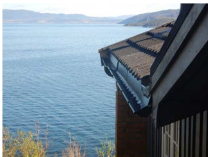
Nedbøy av takrenner etter snøras
