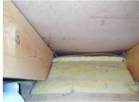
Luftespalte er klemt i sammen på midten.
