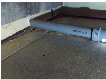
Avløp i fra sluk i dusjnisje er ført til sluk under badekar
