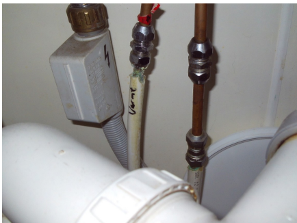
Vannrør i kjøkkenbenken.
