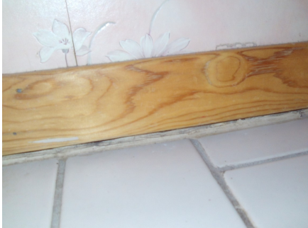
Ingen synlig fuktsikring i overgang gulv og vegg
