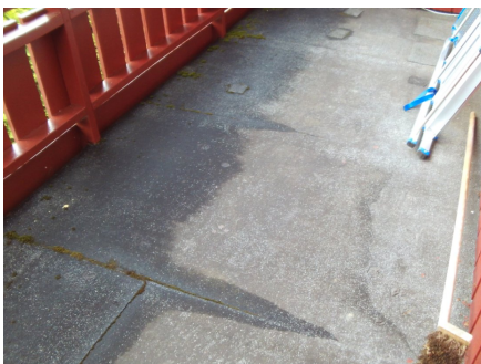
Eldre noe slitt tekking over soverom
