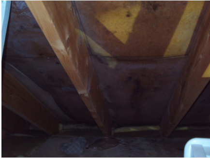
En del kondens/fuktmerker på sutakplater.
