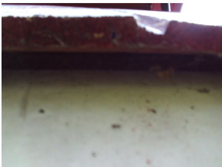
Ingen/lite tilgang på luft ved grunnmur.
