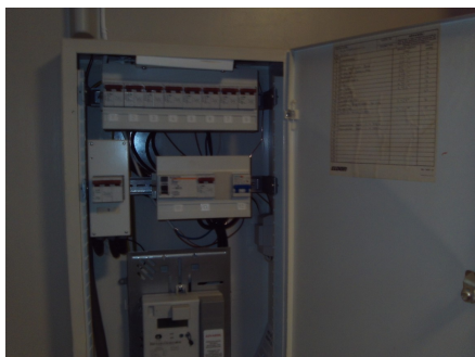
Sikringsskapet er plassert i vindfang
