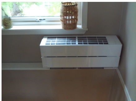
Varmepumpe i trappeoppgangen.
