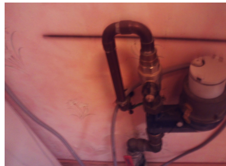
Innvendig stoppekran med vannmåler
