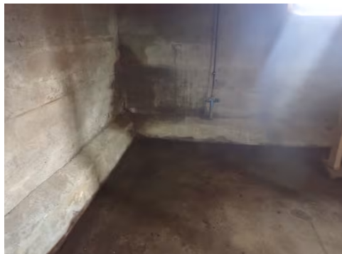
Fukt i grovkjeller mot nord.
