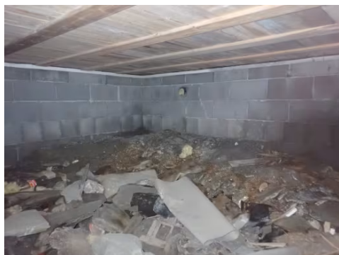
Kryprom uten fuktsperre mot grunnen.
