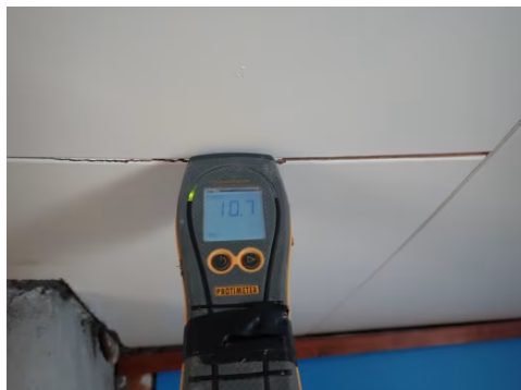
Nedbøy i himlingsplater på soverom 1 ved pipe.
