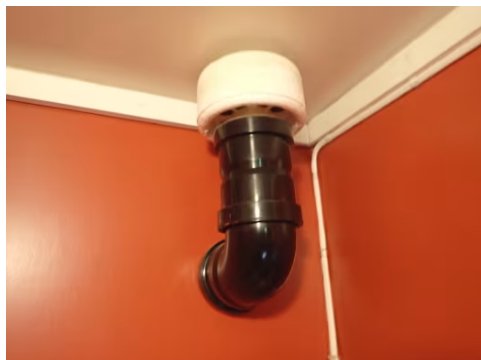
Vaccumventil på toalettrom.
