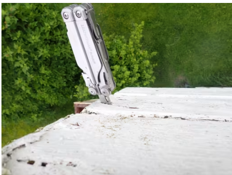
Råte i raftekasse.
