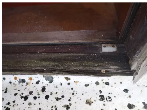
Råte i rømningsdør på loft.
