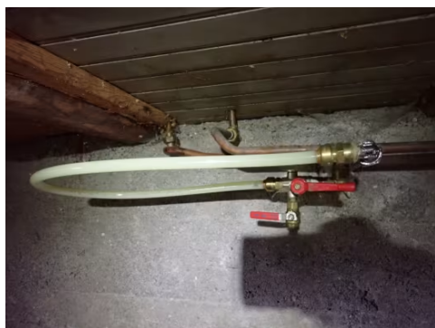
Rør i rør og kobberrør i kjeller.
