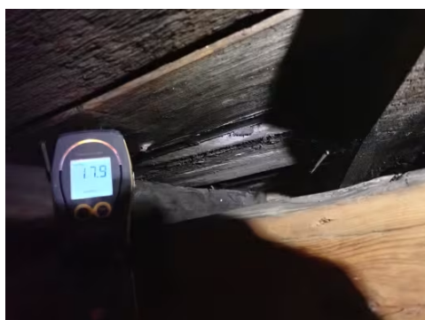
Forhøyede fuktverdier på kaldtloft over soverom 1.
