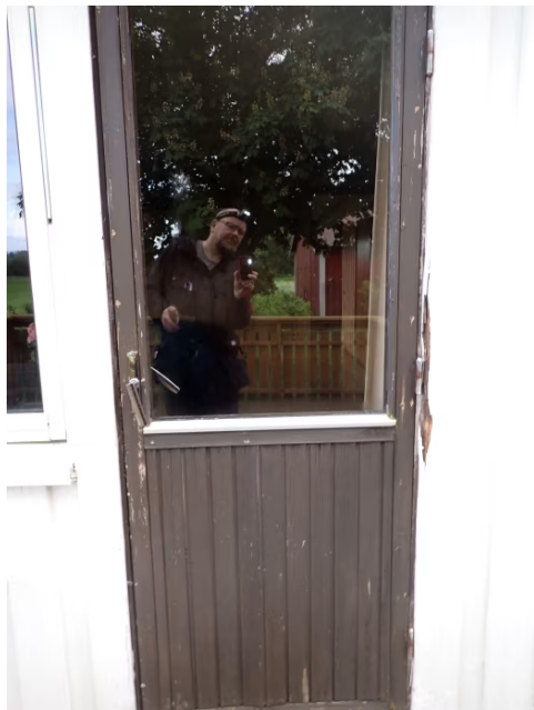
Fuktskade og råte i terrassedør.
