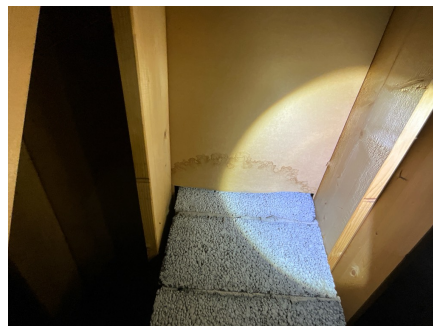
Fuktmerke ved pipe
