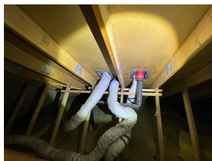
Fuktmerker rundt luftehatter
