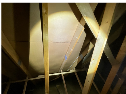
Fuktmerke på takside ut mot parkering/garasje
