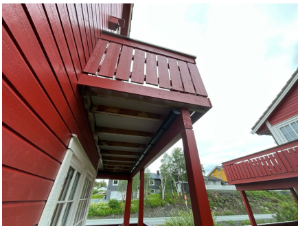
Oversiktsbilde av påviste avvik ved søyle.
