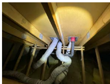
Fuktmerker rundt luftehatter
