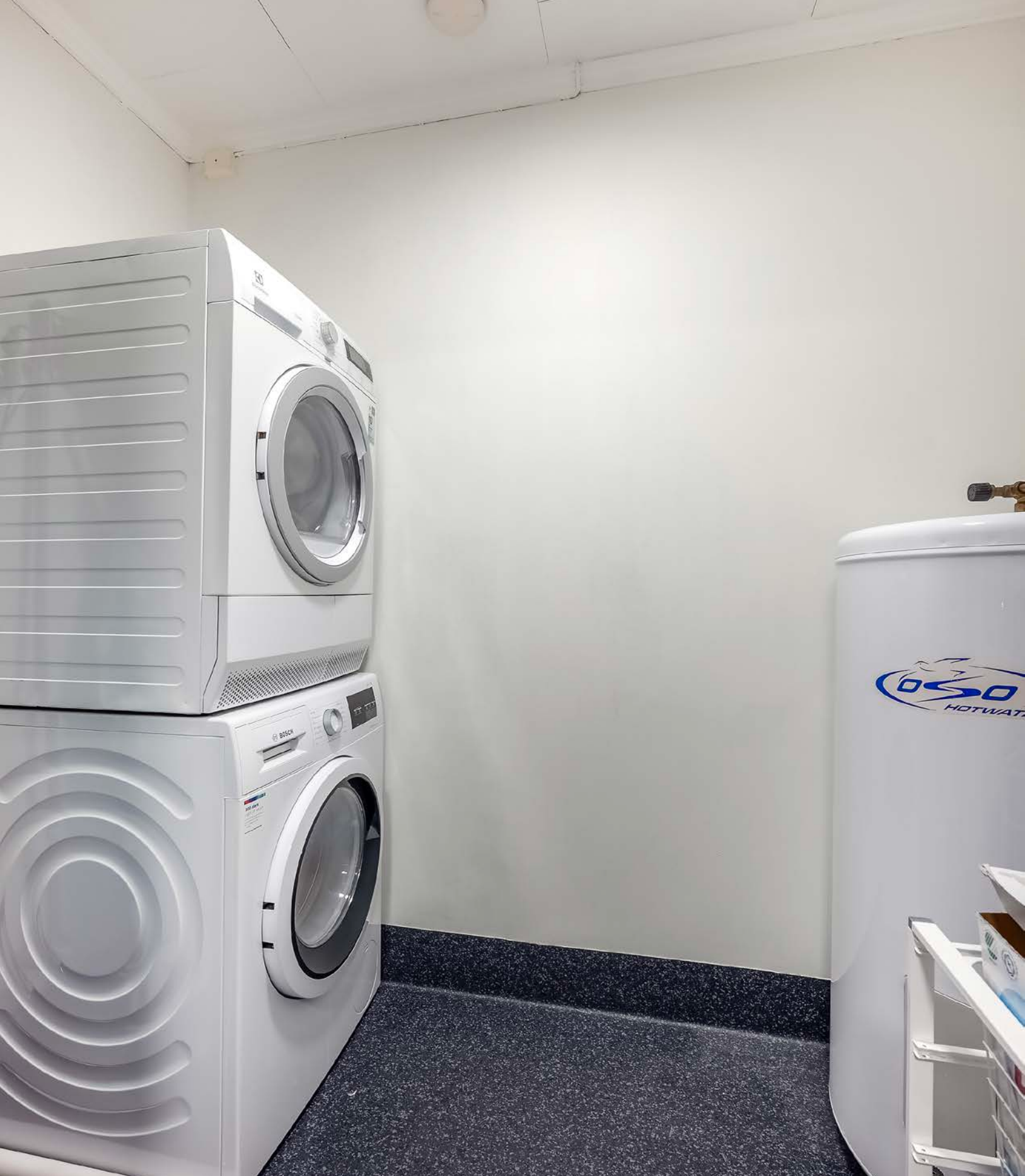
Vaskerommet er nylig oppgradert med bl.a. nytt gulvbelegg
