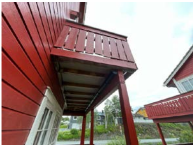
Oversiktsbilde av påviste avvik ved søyle.
